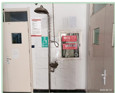
图1 4#实验楼喷淋装置
