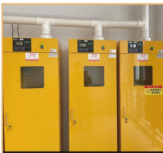
图23 专用气瓶储存柜
