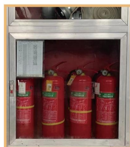
图19 消防器材检查
