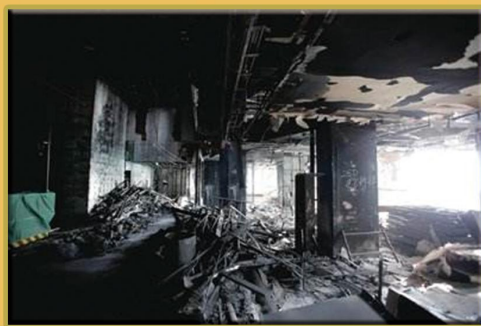
(事故后被烧毁的大楼)
