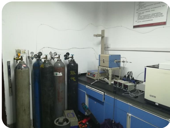
图 3. 材料楼 n201 室气瓶未固定，供气管路不规范
