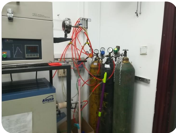
图 4. 材料楼 n301 室气瓶未固定，供气管路不规范
