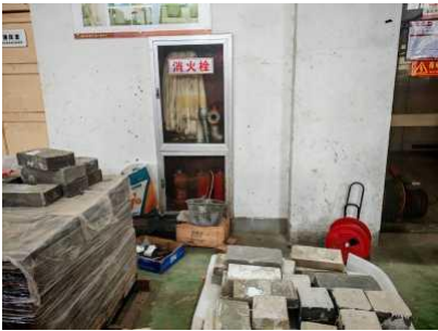
消防设施门被障碍物阻挡
