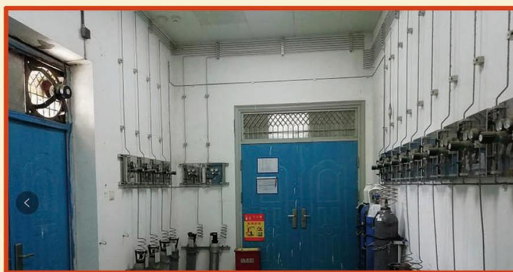
图五 标气间气瓶固定、配备气体泄漏检测设备
